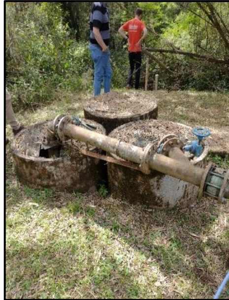
Figura 61. Captação da água bruta do Arroio Portão para abastecimento de água do município de Glorinha.
