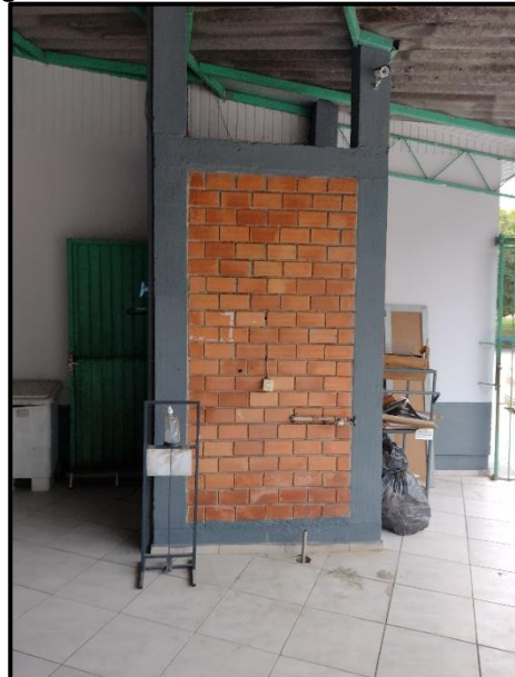
Figura 98. Estrutura do dosador de cloro.
