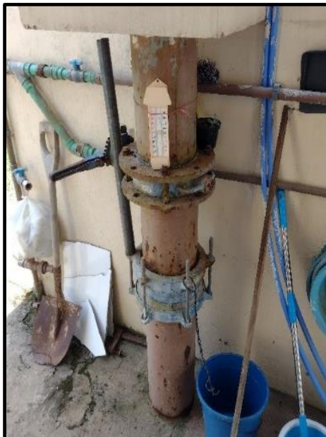
Figura 68. Chegada da água bruta e dosagem dos agentes coagulantes
