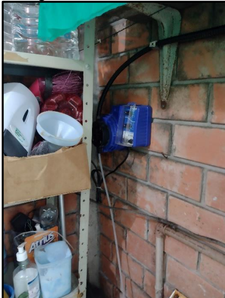
Figura 97. Dosador de cloro.
