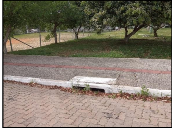
Figura 23. Boca de lobo.
