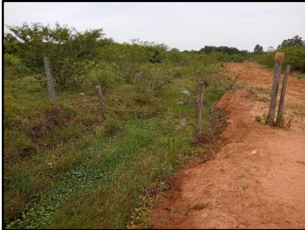
Figura 25. Problemas de drenagem.
