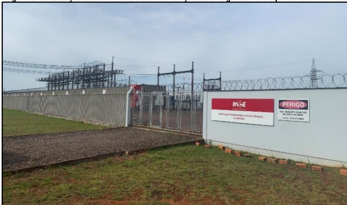
Figura 8. Subestação transformadora de distribuição de energia do município de Glorinha/RS.
