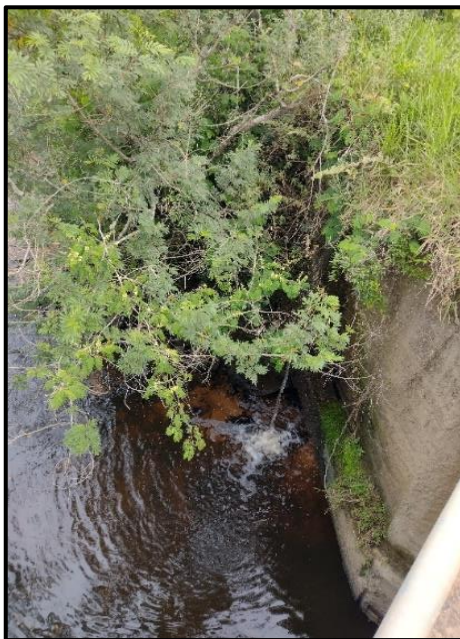
Figura 123. Ponto de emissão do efluente tratado da ETE.
