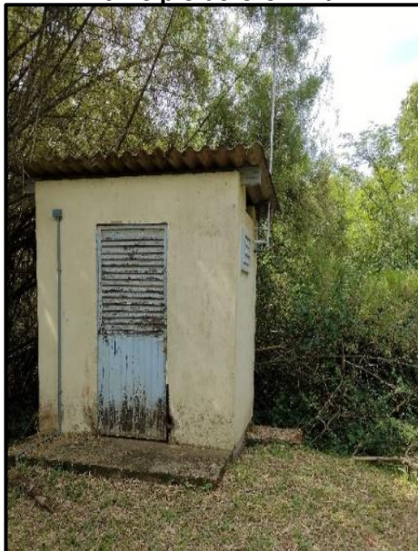
Figura 62. Captação da água bruta no município de Glorinha.
