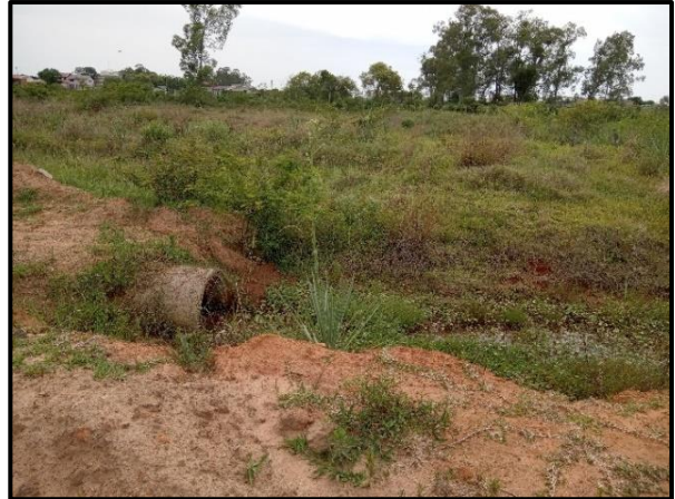
Figura 26. Problemas de drenagem.
