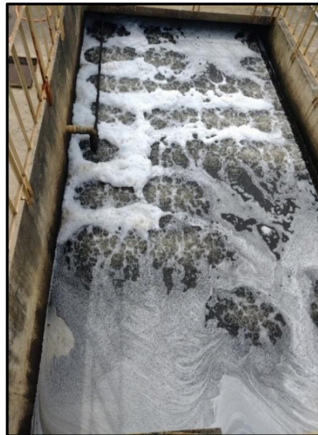
Figura 114. Filtros biológicos aerados da ETE-Glorinha.
