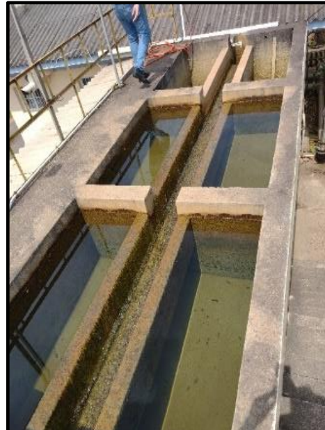
Figura 69. Tanques onde ocorrem os processos de floculação e filtração
