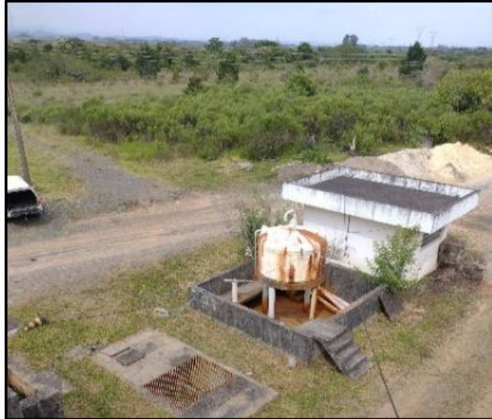
Figura 118. Armazenamento de produtos químicos.
