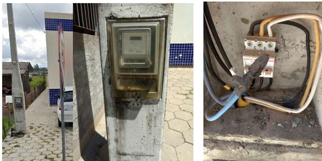
a) Quadro de medição b) disjuntor geral (63A) Figura 9: Quadro de medição USF MARIA DA GLÓRIA
