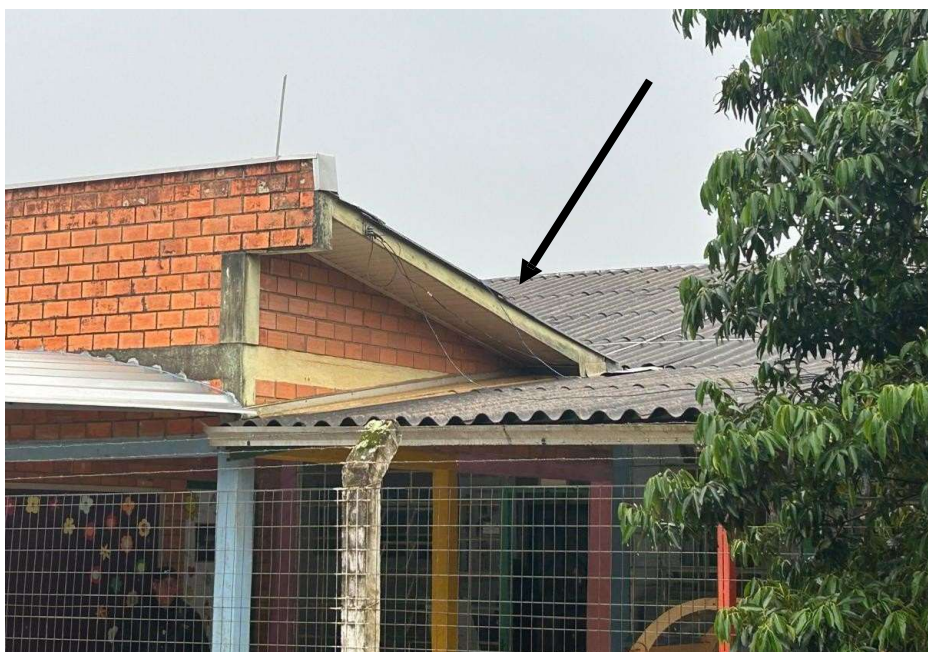
Imagem 4. Foto do encontro das águas dos telhados e localização da calha a ser substituída por de uma de maior vazão.
