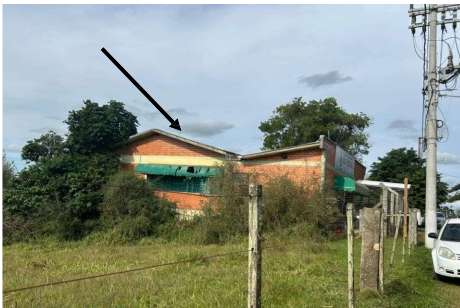
Imagem 3. Fachada noroeste onde ocorrerão as intervenções em funilaria – Capa de beiral.
